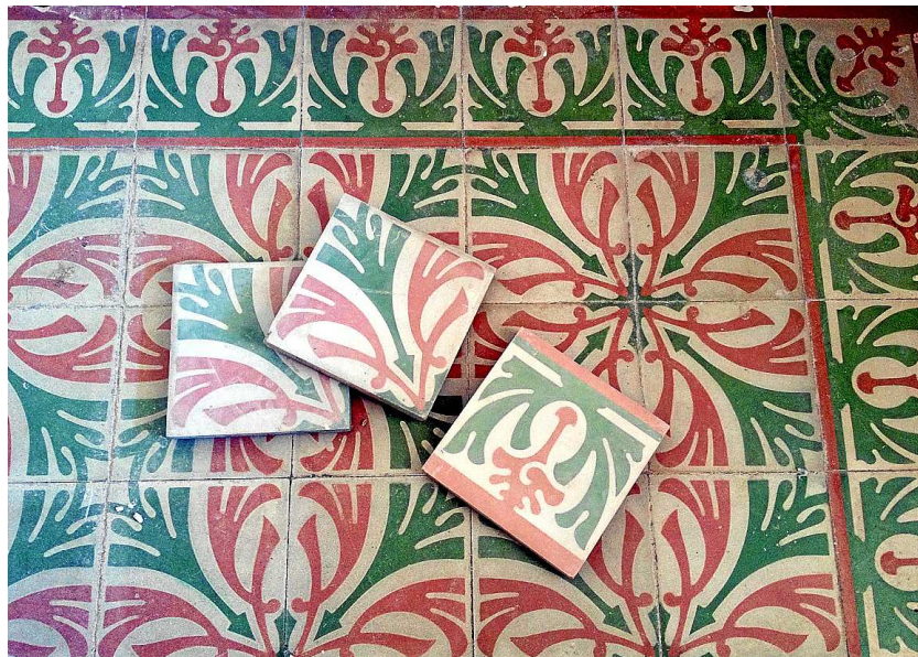
Für beinahe alle Fußböden, wie hier für den Jugendstil-Steinboden im Erdgeschoss, fanden sich im Haus Ersatzfliesen. Die Besitzer ließen unter die alten Steine Fußbodenheizungen verlegen.
